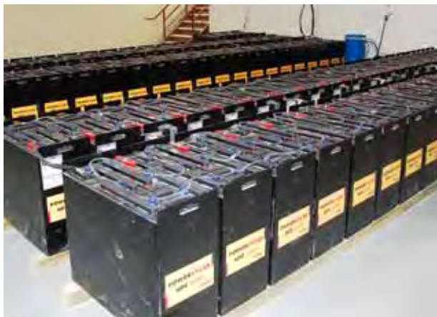
Рис. 2.1. Массив аккумуляторов, обеспечивающий мощность 60 кВт при 480 В постоянного тока и используемый в качестве резервного источника питания для корпоративного центра обработки данных. (Фотография публикуется с разрешения компании Hybridne Power Systems, Canada, Inc. и группы компаний Hybridne. Авторское право на фотографию принадлежит Hybridne, международной зарегистрированной торговой марке компании Hybridne Power Systems Canada Inc. Дальнейшее воспроизведение фотографии не разрешается без специального разрешения от группы Hybridne.)
